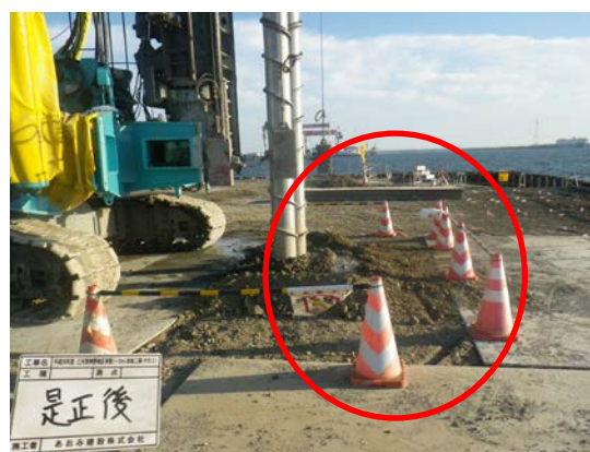
【是正後: 軟弱地盤の危険箇所をコーンで表示】
