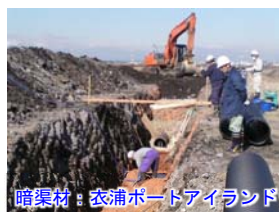
暗渠材 : 衣浦ポートアイランド
