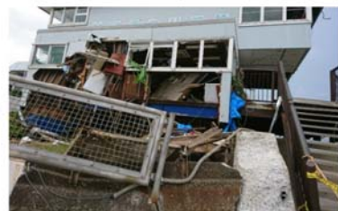
管理棟の被災状況
