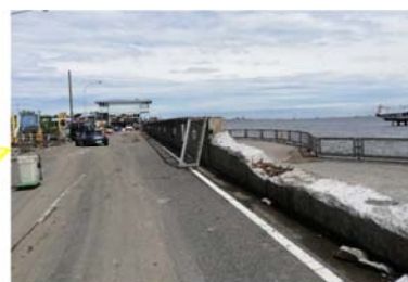
護岸の被災状況 (14カ所のべ230m)
